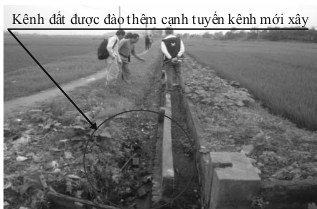
Hình 2. Tuyến kênh xây không phù hợp với nhu cầu sản xuất
