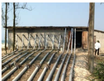
Hình 12: Trạm bơm cố định
